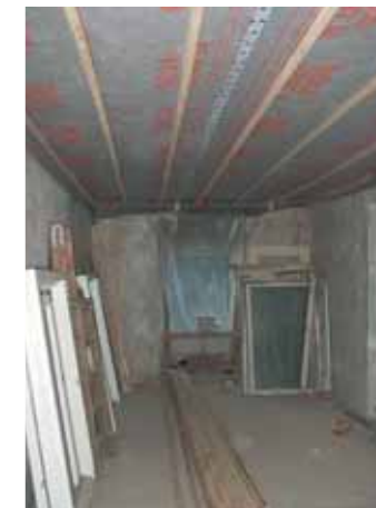
Um die Innenräume luft- dicht zu machen, wurde beispielsweise unter den Decken eine diffusions- offene Dachunterspann- bahn befestigt.
